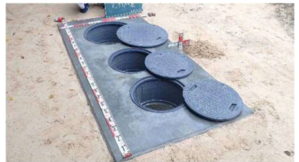
【合併処理浄化槽】
