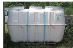
合併処理浄化槽
