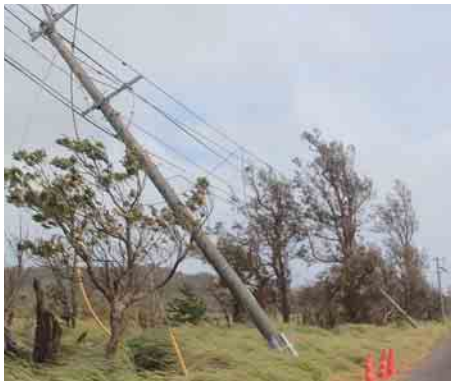
根元から折れ曲がった電柱
