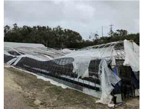
ハウスなどの農業施設も多く被災した
