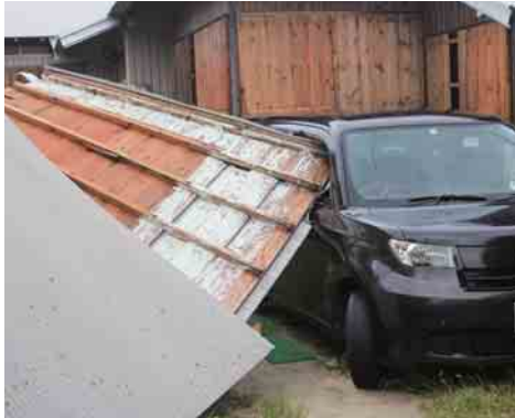
破損した家屋の一部が車の窓を破壊
