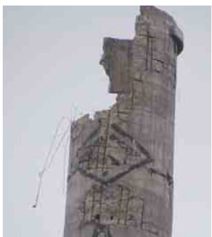
旧大和製糖の煙突も破損
