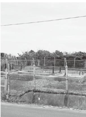
東部地区簡易水道
